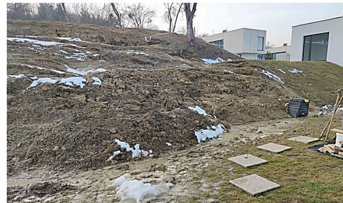
Deslizamiento de tierra después del invierno
